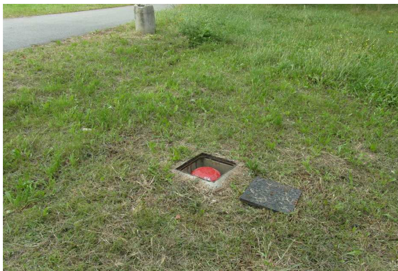
Figura 9 – Il piezometro esterno P34
